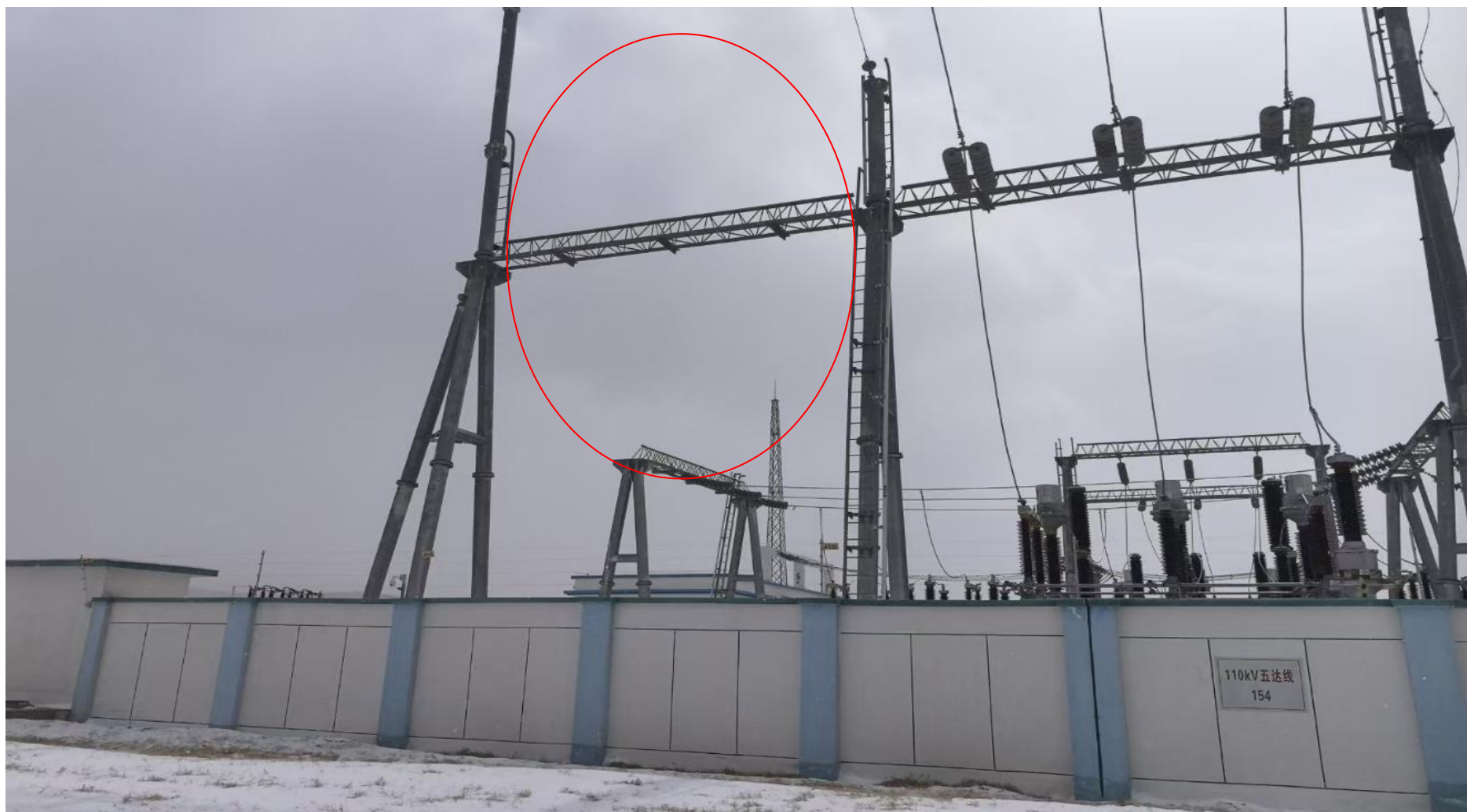
图 2-18 乌兰 110kV 变电站本期扩建间隔（红色椭圆内）
