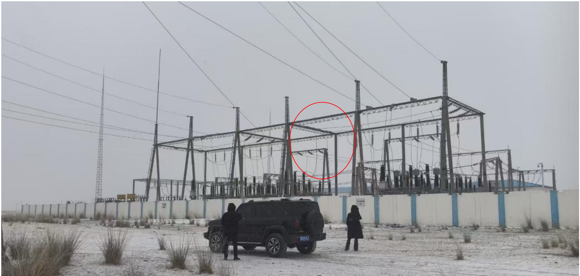
图 2-4 本期扩建吉林郭勒 110kV 变电站乌兰间隔（红色椭圆内）
